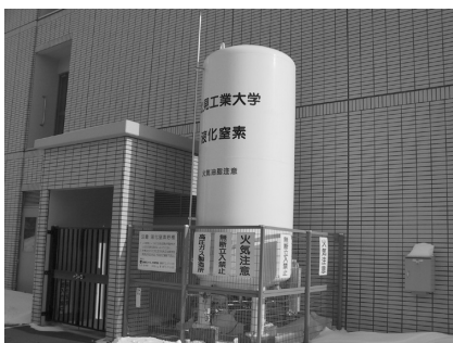
液体窒素の大型貯蔵タンク 3号館
